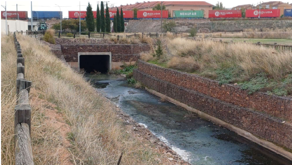
Imagen de salida a cauce abierto de la cañada Romero dentro de la zona de renaturalización
