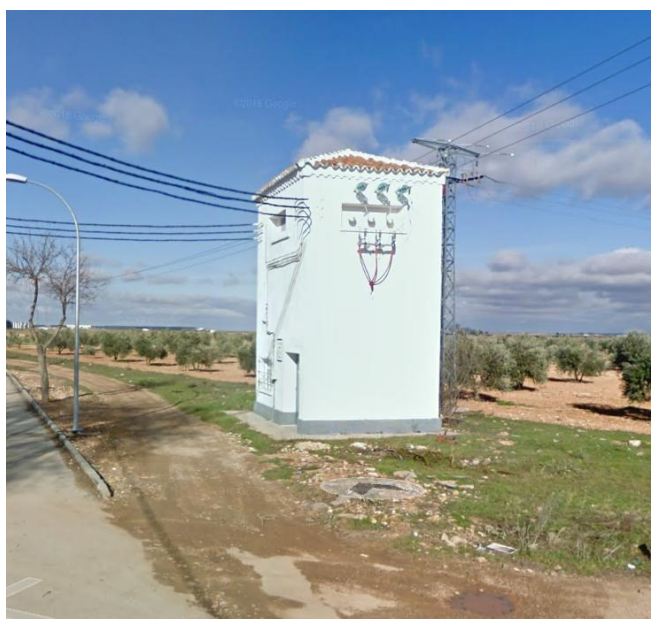
Centro de Transformación existe en Consolación
