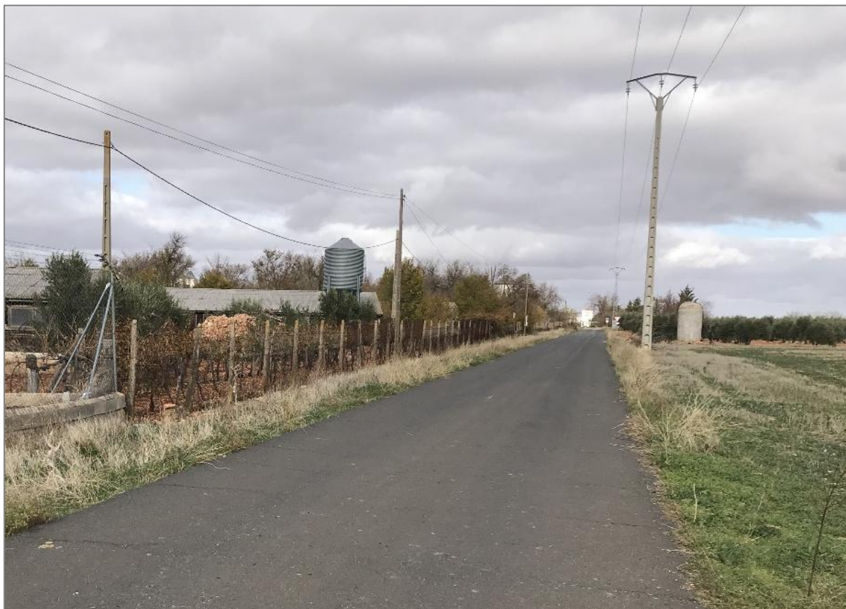
CR-5214. Margen derecha. Línea aérea media tensión fuera del Sector 40 "Consolación Sur".
